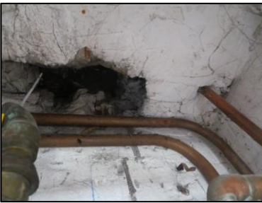
Photo N° 1263 AMIANTE CIMENT -- placards technique +3 Plafonds Ventilation haute (Fibres-ciment)
